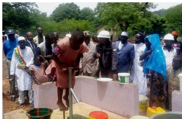
Accès à l'eau installé dans l'école de Longoma
